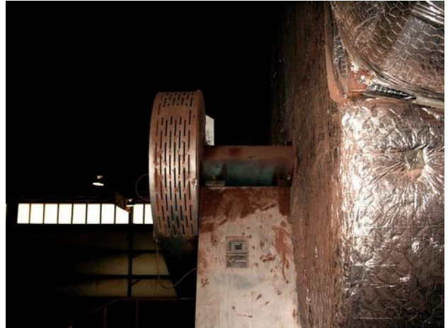
Hot air exhaust fan
